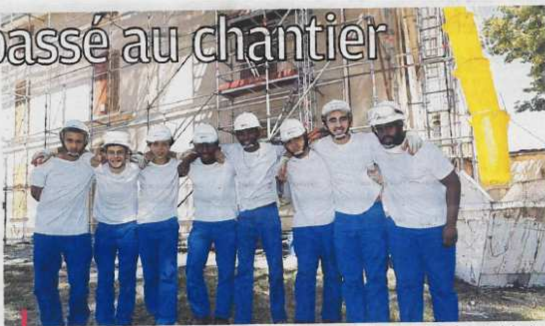
Issus des quartiers populaires de la cité phocéenne, huit jeunes travailleurs œuvrent à la réfection du château de Fabrégoules, à Septème-les-Vallons. / PHOTO PHILIPPE LAURENSEN
