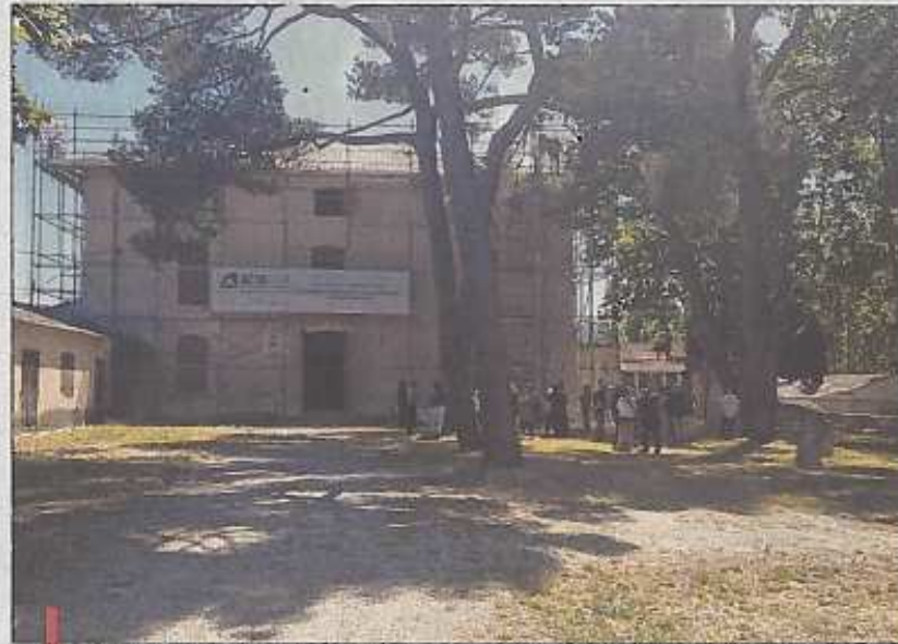
Acta Vista et Bao Formation sont à la tête de cette rénovation qui a permis de former des jeunes de moins de 26 ans au métier de couvreur zingueur. / PHOTO P.G.
